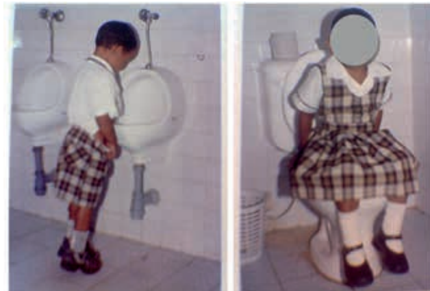
Inadecuada altura de instalación de aparatos sanitarios
