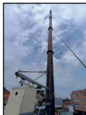
N.º 31. Ducto de descarga de caldera Colcalderas de 15 BHP - sede 1.
