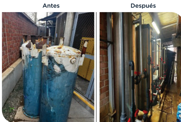
Cambio PTAP. Fuente propia.
